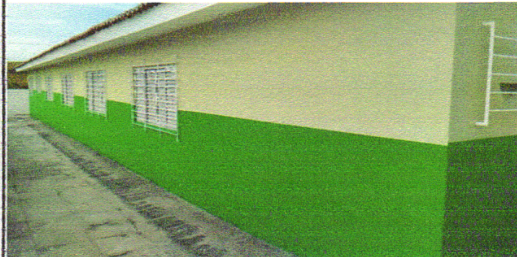
PINTURA ACRÍLICA EM PAREDES E PINTURA ESMALTE NAS GRADES DE PROTEÇÃO DAS JANELAS
