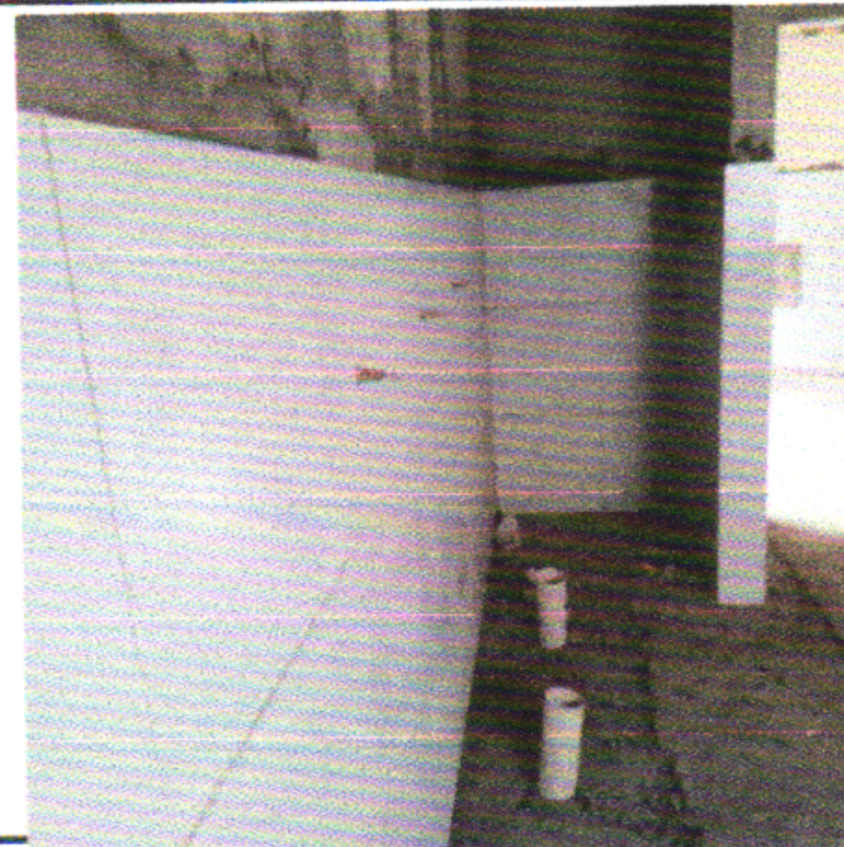
PONTO DE AGUA E ESGOTO
