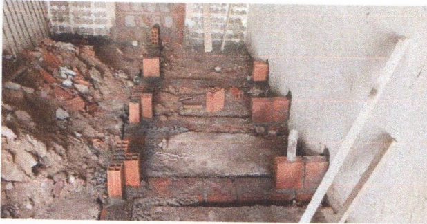
ESCAVAÇÃO, CONCRETAGEM E ALVENARIA DE BLOCO CERÂMICO NA BASE DO WC MASCULINO
