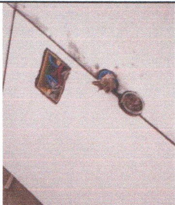
PONTOS DE ESGOTO
