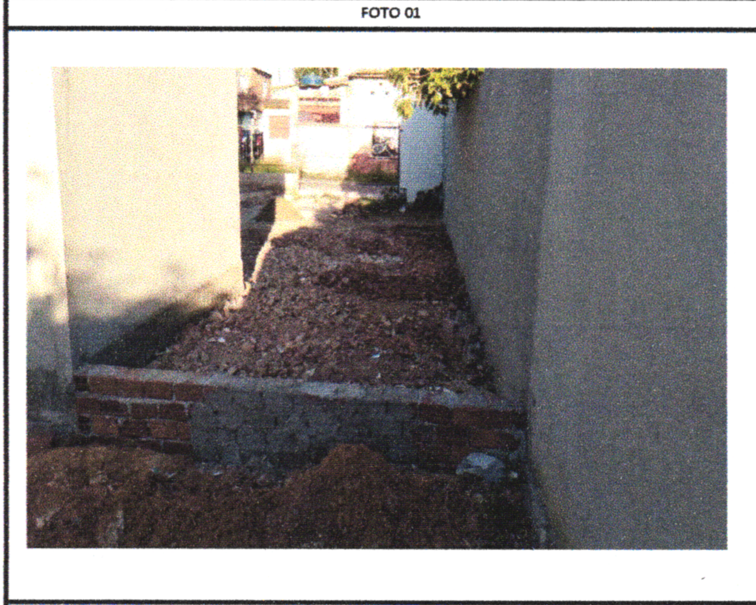
1.3.2 - PREPARO DE FUNDO DE VALA COM LARGURA MENOR QUE 1,5 M (ACERTO DO SOLO NATURAL). AF_08/2020
