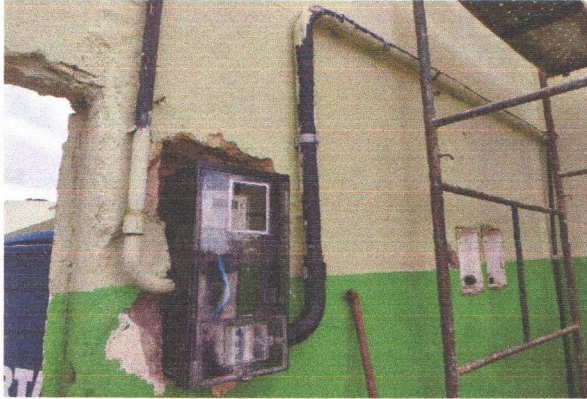
ESCOLA MUNICIPAL INÁCIO GOMES DA SILVA - ENTRADA DE ENERGIA (CAIXA DO MEDIDOR E ELETRODUTO, CURVA E LUVA)
