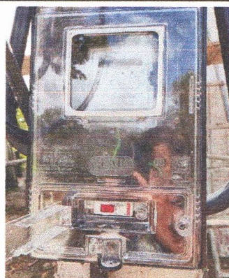
ESCOLA MUNICIPAL SENADOR FRANCISCO GOMES DE ARAUJO - ENTRADA DE ENERGIA (CAIXA DO MEDIDOR E COM DISJUNTOR MONOFÁSICO 40A)
