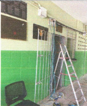
ESCOLA MUNICIPAL INÁCIO GOMES DA SILVA - CIRCUITOS ELÉTRICOS DOS AR CONDICIONADOS
