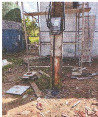
ESCOLA MUNICIPAL SENADOR FRANCISCO GOMES DE ARAUJO - ENTRADA DE ENERGIA (CAIXA DO MEDIDOR E ELETRODUTO, CURVA E LUVA)
