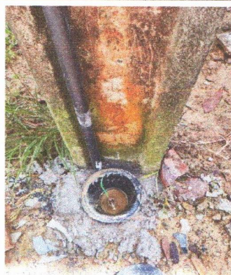
ESCOLA MUNICIPAL SENADOR FRANCISCO GOMES DE ARAUJO - CAIXA, HASTE DE ATERRAMENTO COM CONECTOR
