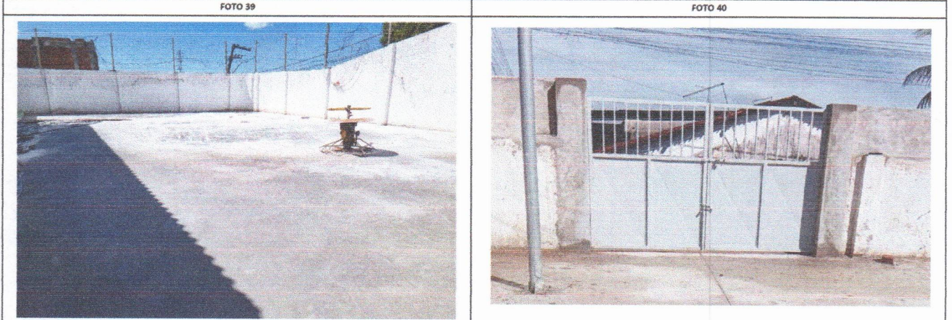
ESCOLA MUNICIPAL INÁCIO GOMES DA SILVA - PISO DA QUADRA EM CONCRETO ARMADO ESCOLA MUNICIPAL INÁCIO GOMES DA SILVA - PORTÃO EM FERRO DUAS FOLHAS (ENTRADA DE VEÍCULOS)
