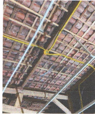
ESCOLA MUNICIPAL FRANCISCO TAVARES - ELÉTRICA
