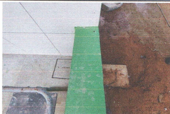
ESCOLA MUNICIPAL FRANCISCO TAVARES - ELÉTRICA
