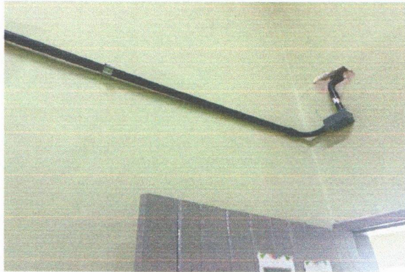
ESCOLA MUNICIPAL APOLÔNIO SALES - ELÉTRICA
