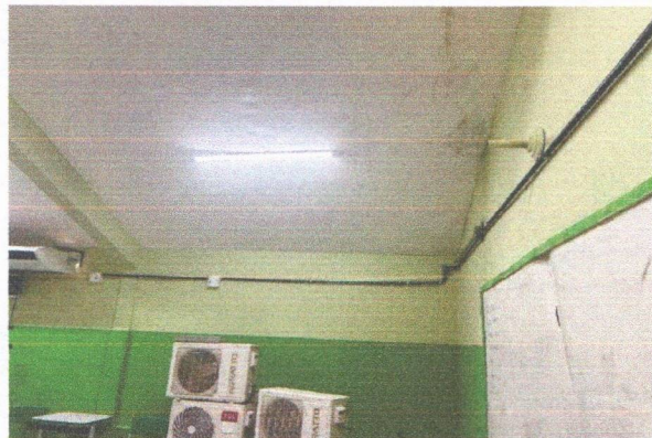
ESCOLA MUNICIPAL APOLÔNIO SALES - ELÉTRICA
