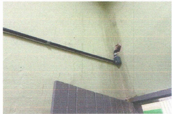
ESCOLA MUNICIPAL APOLÔNIO SALES - ELÉTRICA
