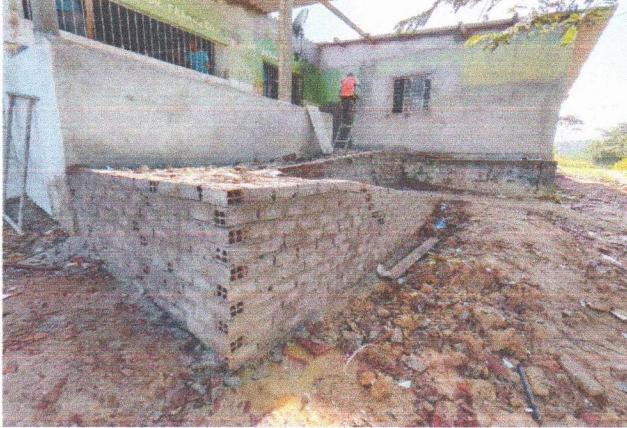
ESCOLA MUNICIPAL SENADOR FRANCISCO GOMES DE ARAÚJO - ASSENTAMENTO DE BLOCO CERÂMICO PARA A RAMPA DA ENTRADA
