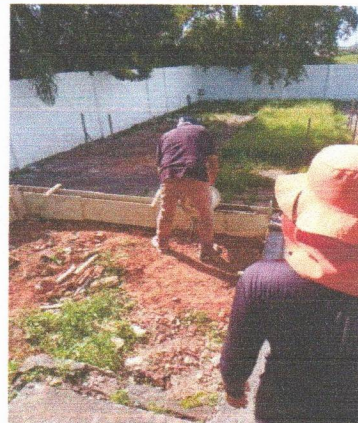
ESCOLA MUNICIPAL APOLÔNIO SALES - VIGA NA CONTENÇÃO PRÓXIMO DO PÁTIO
