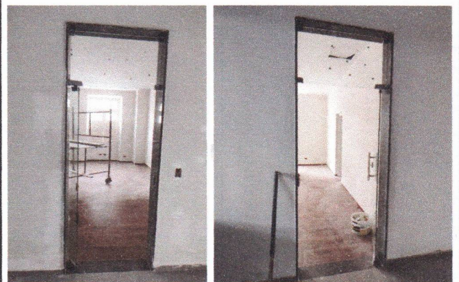
REVESTIMENTO EM GRANITO ENTORNO DA PORTA DE VIDRO E SOLEIRA EM GRANITO (PREFEITURA SEDE)
