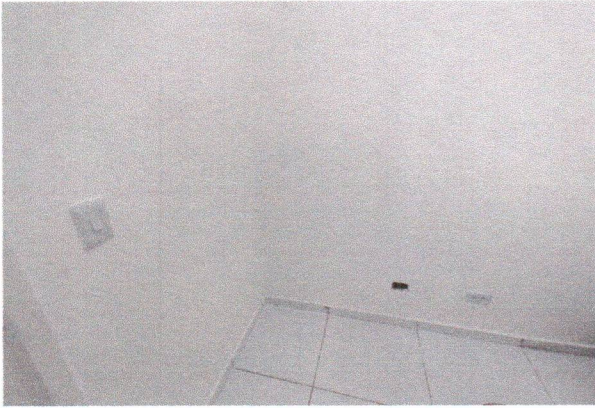
PONTOS ELÉTRICOS (ANEXO LATERAL)
