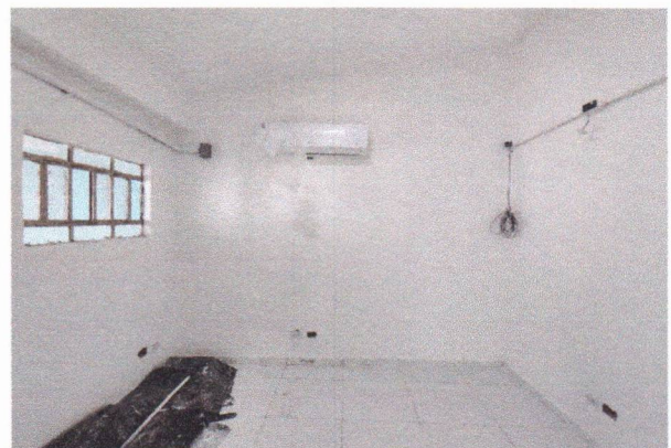
PONTO DE AR CONDICIONADO E PONTO DE TOMADAS (ANEXO LATERAL)
