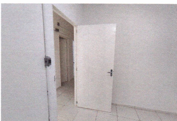
PINTURA ACRÍLICA NAS PAREDES, EMASSAMENTO E PINTURA ESMALTE NAS PORTAS (ANEXO LATERAL)
